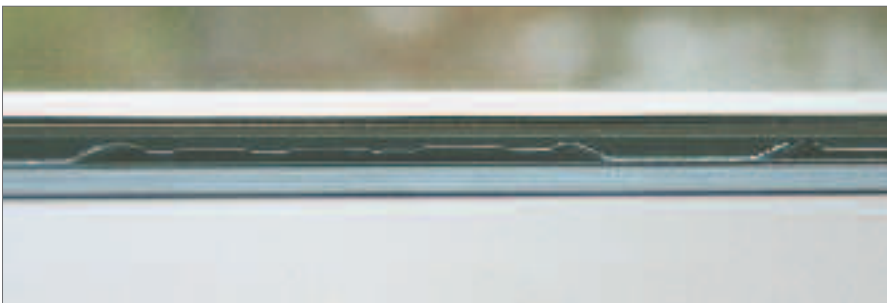
Foto 1: Dieses Foto zeigt Butylverquetschungen über die ganze Länge des Abstandhalters.
