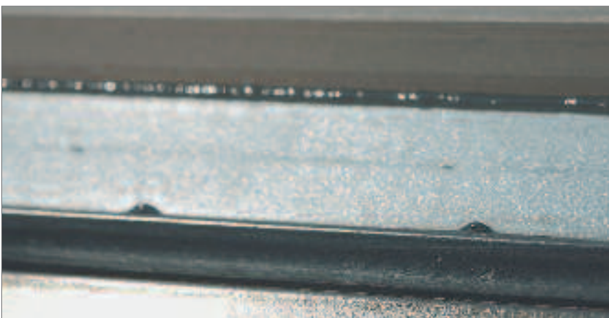
Foto 3: Diese Aufnahme zeigt punktuelle Butylverquetschungen am Isolierglas.
